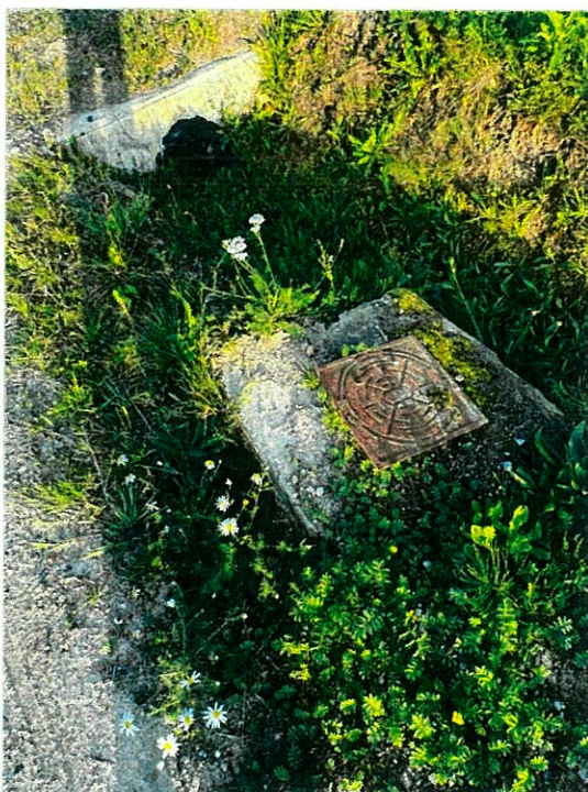
Zdjęcie nr 3 – ubytek przy obrzeżu (z bliska)
